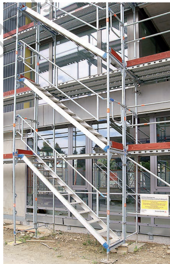
Abb. 1/220: Arbeitsplatz- erschliessung durch Gerüst
