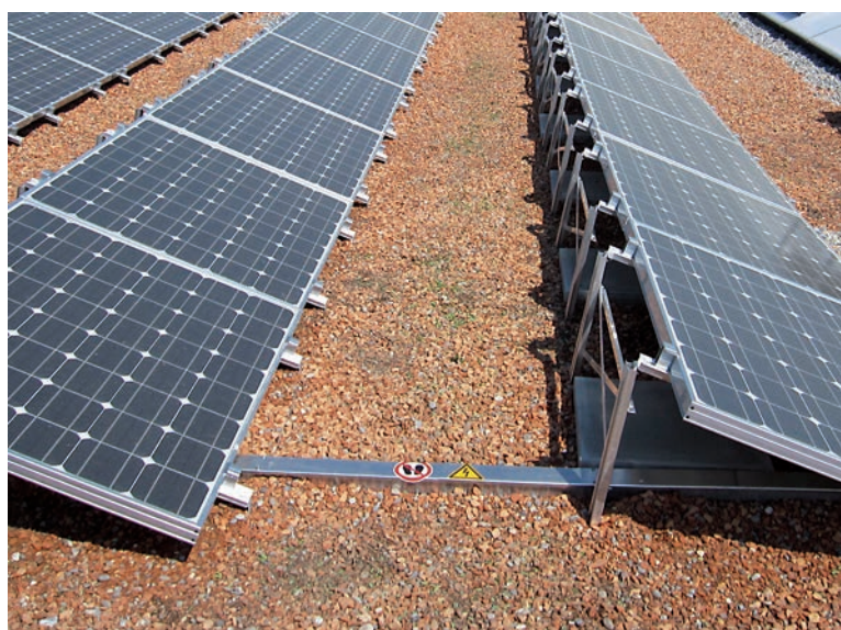
Abb. 3/1010: Solarmodule auf Flachdach; Aufständerrung
