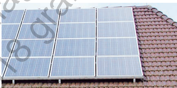
Abb. 3/1009: Solarmodule in Überdach-Montage (Aufständerrung)
