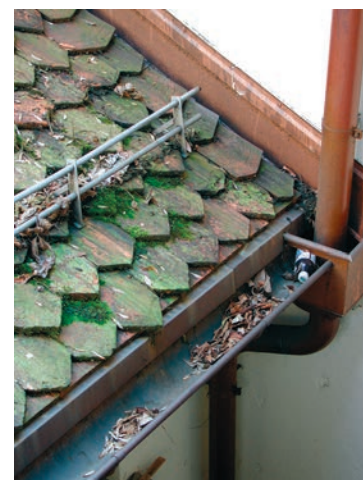
Abb. 3/702: Entwässerungssysteme sollen regelmässig gereinigt werden
